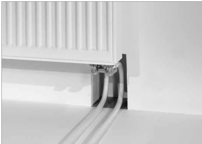
Heizkörperanschluss aus der Wand
