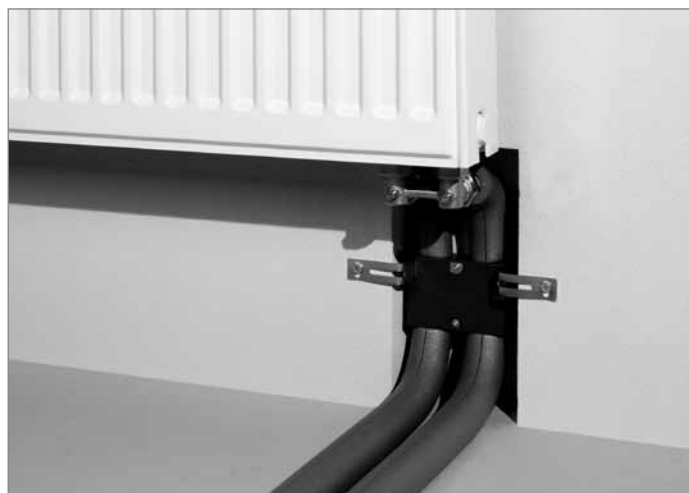
Heizkörperanschluss mit Montagemodul – an den Hahnblock angeschlossen
