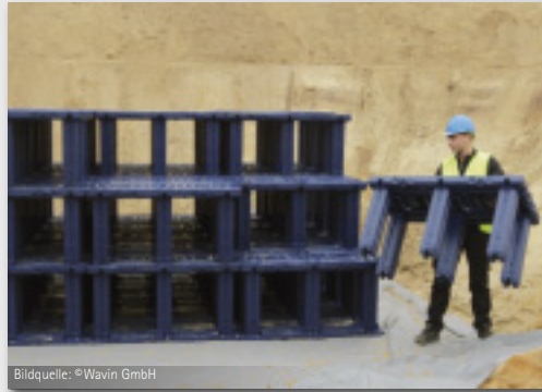
Rigolen ermöglichen eine Zwischenspeicherung und verzögerte Versickerung großer Mengen an Niederschlagswasser bei Starkregeneignissen
