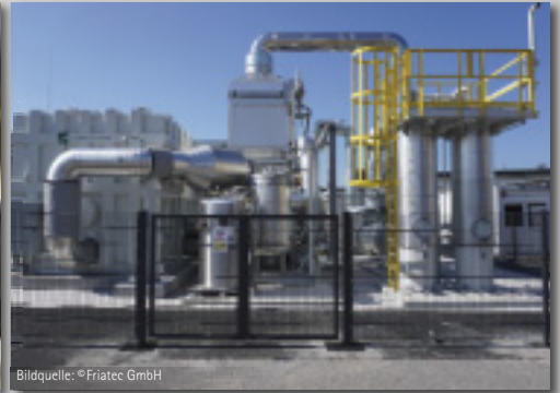
Ein Brennstoffzellenkraftwerk versorgt die FRIATEC GmbH mit sauberer Wärme und Energie
