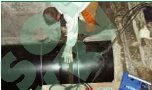
Bild 2 + 3: Das Einbringen der Rohrmodule in die Baugrube und Einziehen in das Altrohr
