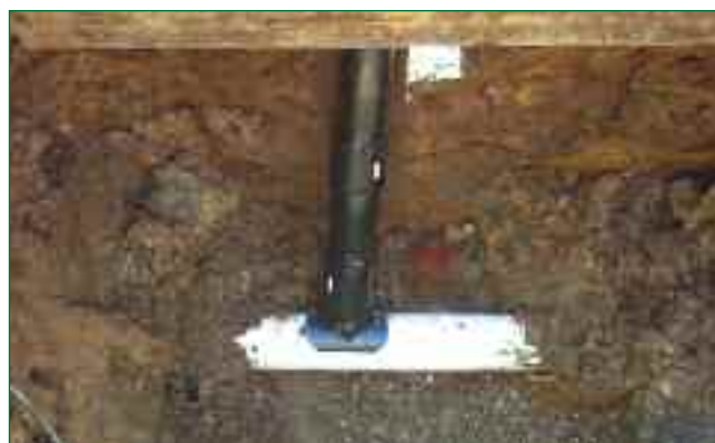
Bild 10: Anschluss des Sattelstutzens an den PE-Liner und Sanierung der Anschlussleitung in offener Bauweise mit einem PE 80-Rohr
