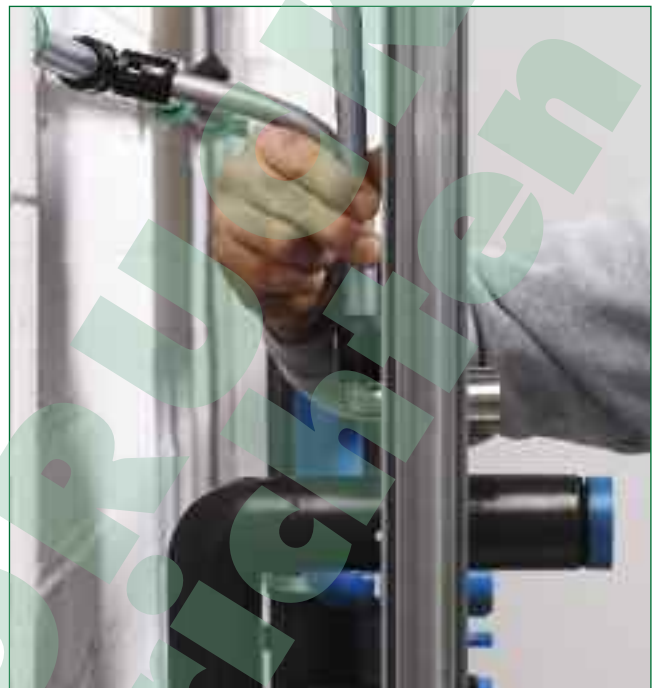
Bild 1: Moderne und wirtschaftliche Installationstechnik in der Vorwand
