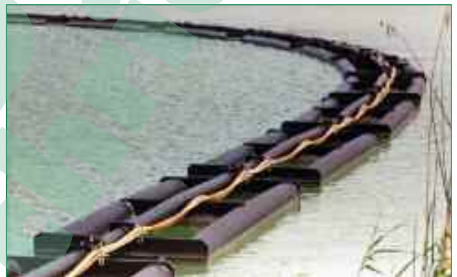
Bild 5: Befestigung der Energiekabel und des Förderrohres auf den korrosionsfesten Schwimmpontons aus Polyethylen (PE-HD). Trotz der festen Flanschverbindung des Förderrohres ist eine flexible Rohrleitung auch ohne Gelenkstücke möglich
