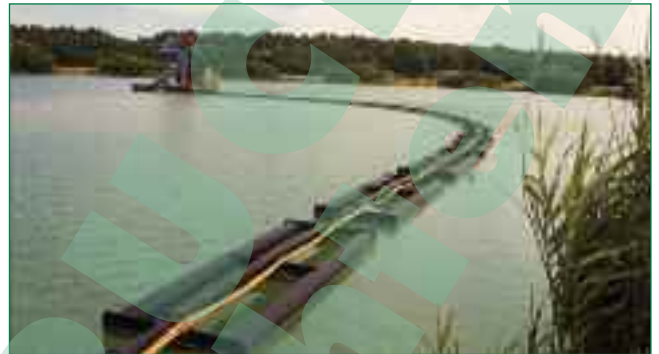
Bild 4: Schwimmbagger mit Saugleitung zum Abtransport des Feinsandes. Die Positionierung des Schwimmbaggers erfolgt über Ankertrosse
