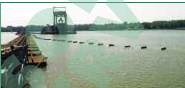
Bild 10: Die Unterwasserführung der Förderleitung vermindert die Windangriffsfläche und reduziert somit die daraus resultierenden Zugkräfte auf das Ankersystem des Schwimmbaggers
