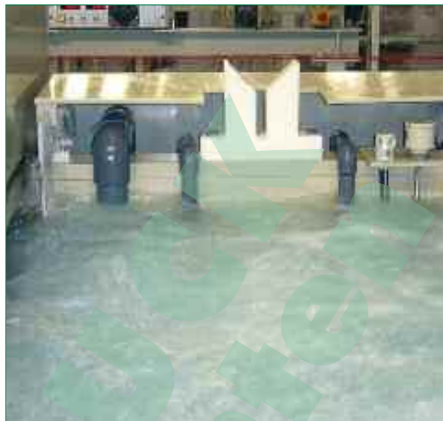
Bild 4: neues Galvanikbad mit PVC-U-Rohren und Formteilen
