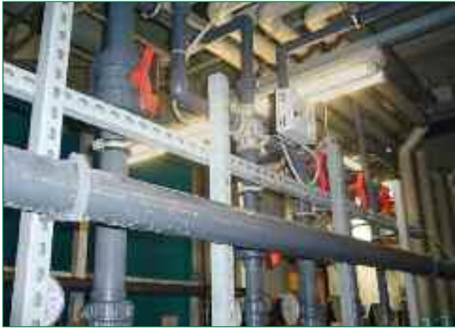
Bild 1: PVC-U- und PP-H-Verrohrung für Kühlwasser und Chemikalien
