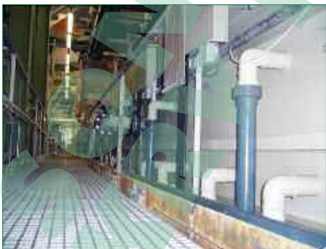
Bild 3: Galvanikstrassenerweiterung, Rohrleitungen in PVC-U und PP-H
