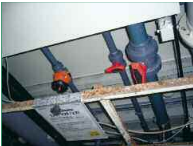
Bild 2: PVC-U-Rohre, Handkugelhahn und Handmembranventil für Chemikalienverrohrung
