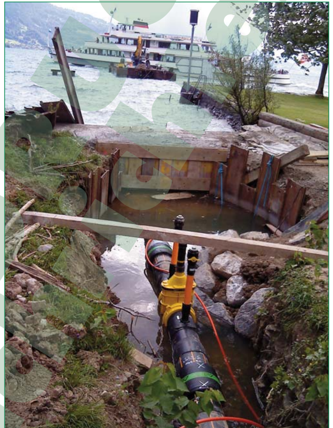
Bild 2: Einbindung einer Absperrarmatur am Übergang vom See zum Land
