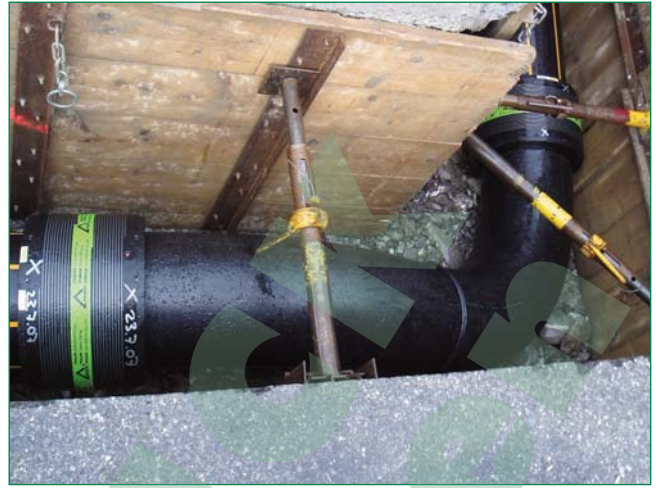
Bild 8: Etage und 90°-Bogen – Rohrführung unter beengten Platzverhältnissen
