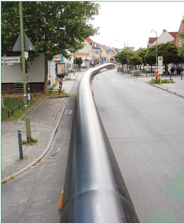
Bild 1: Der 500 m lange Rohrstrang wurde in einem Einzug in das Altrohr eingezogen
