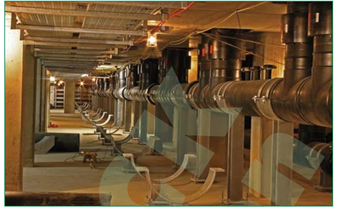
Bild 3: Aufgeständerte PE 100 Sammelleitung unterhalb der Filtrationsmodule
