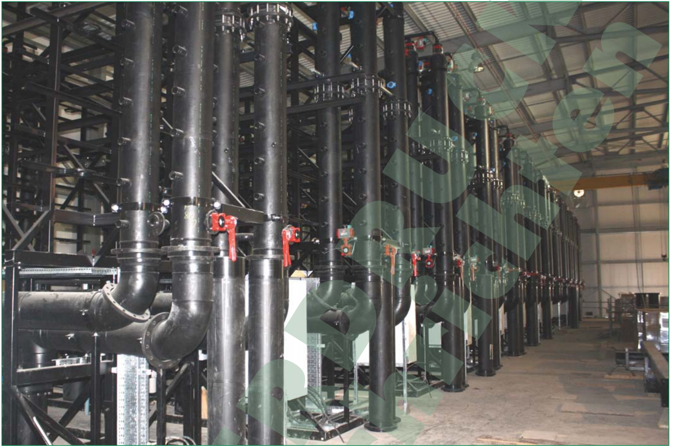
Bild 1: Vorgefertigte Rahmenkonstruktion aus PE 100 zum horizontalen Einspannen der Osmose-Filtermodule
