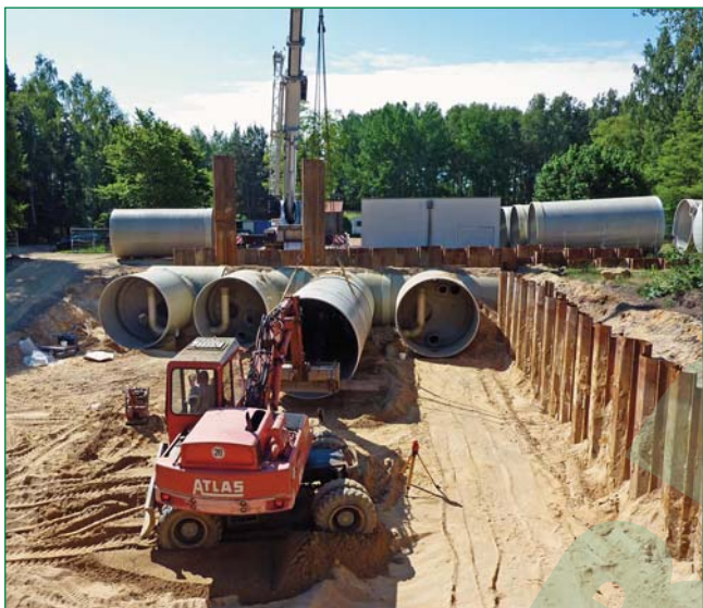
Bild 1: Trinkwasserspeicher Klettwitz: Vier Speicherkammern DN 3000 münden in eine quer dazu liegende Schieberkammer gleicher Nennweite: Alles hergestellt aus GFK-Rohren des FLOWTITE Systems
