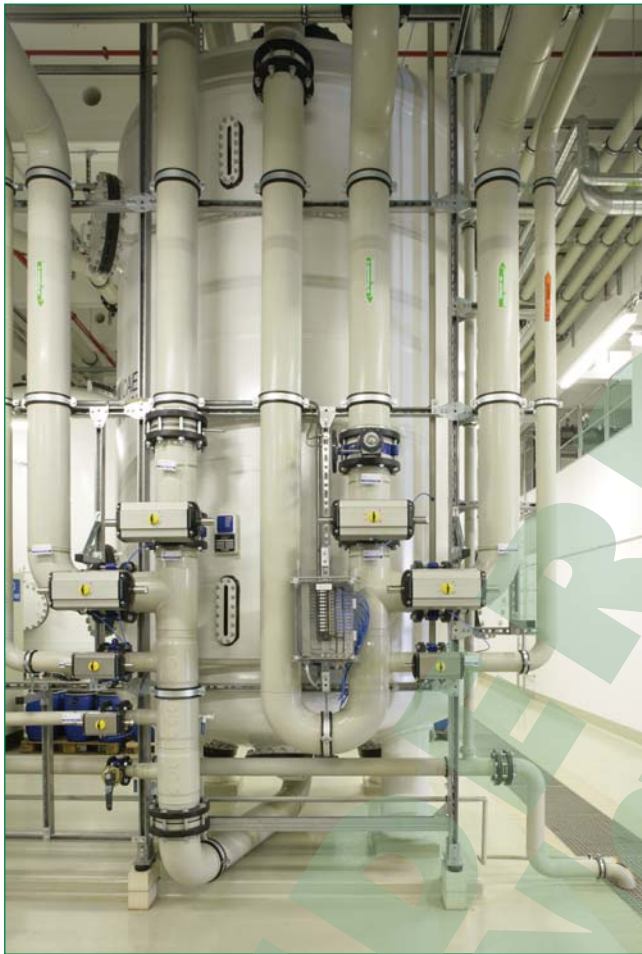
Bild 1: Industrierohrleitung aus PP
