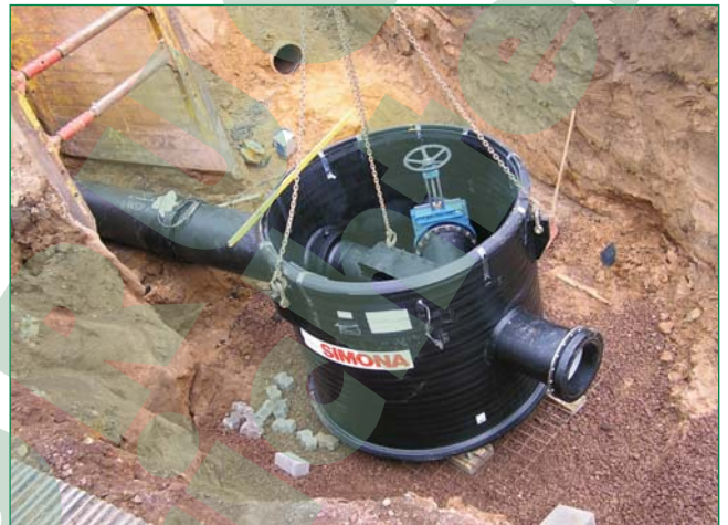
Bild 4: PE-Schacht mit Revisionsöffner und Absperrschieber
