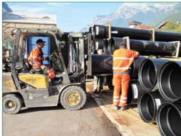
Bild 2: Rohrstangen aus PE 100, Durchmesser 630 x 19,3 mm auf dem Lagerplatz in Amsteg, Hersteller GERODUR MPM, Neustadt, Tochterunternehmen der HakaGerodur AG, Gossau/Benken (CH)
