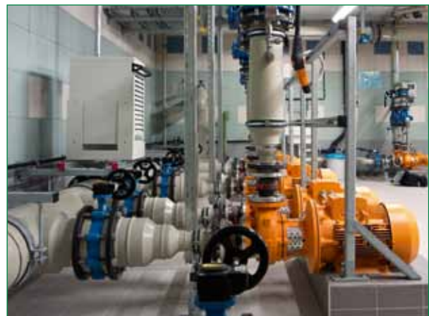
Bild 1: Pumpengruppe zur Wasserenthärtung
