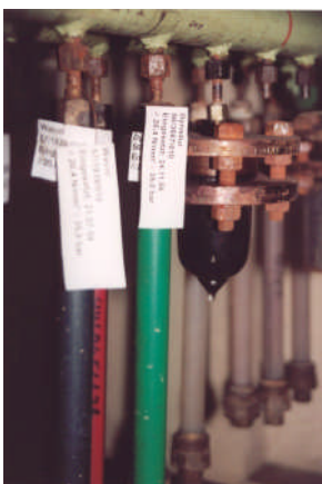
Bild 1: PVC-U-Rohre 32x2,4 mm Wavin und Dynadur seit 21.07.1959 bzw. 24.11.1956 bei 20°C unter 35 bar Innendruck (20,4 N/mm 2 ) am 22.04.2002
