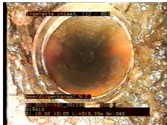
Abbildung 15: NL BBF (Infiltration) S&P: zusätzlich BAH (schadhafte Verbindung)
